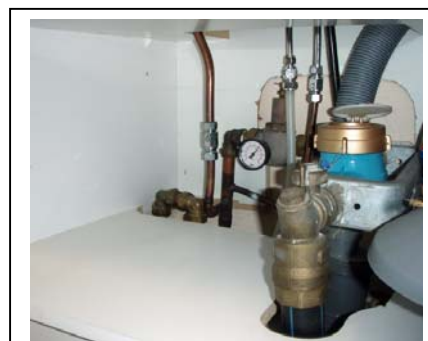
Vesimittari ja paineenalennusventtiili KHH:n allaskaapissa.
