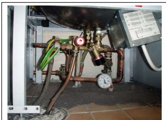
Lämminvesivaraajan alapuolisia asennuksia. Lattiakaivo pölyssä.
